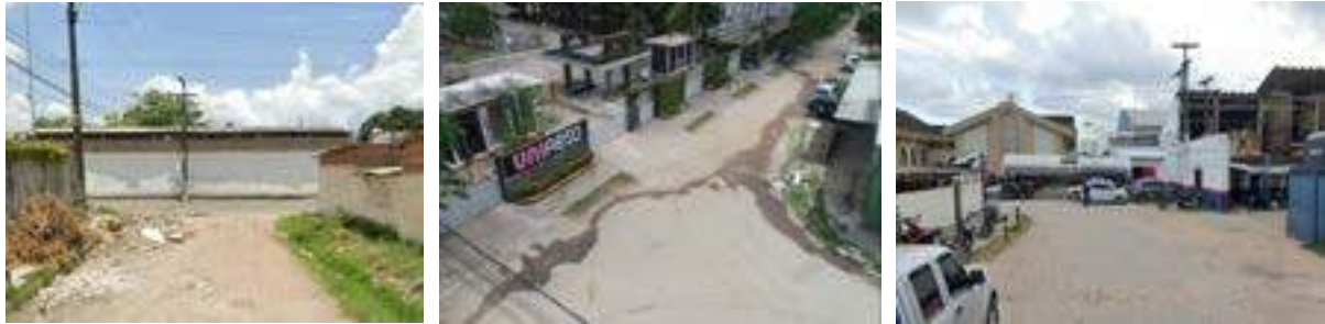
Figura 40 - Vistas das condições de pavimento e sinalização na Rua Napoleão Cordeiro de Lima. Fonte: Fotos ONE, 2023.
